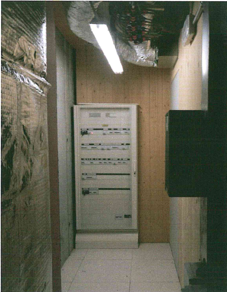
Quadro elettrico nel locale 3P49
